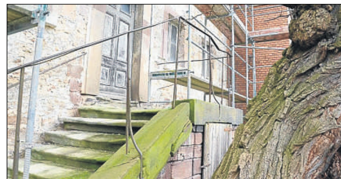
Brüchig: Auch die marode Treppe des Gebäudes muss erneuert werden.
